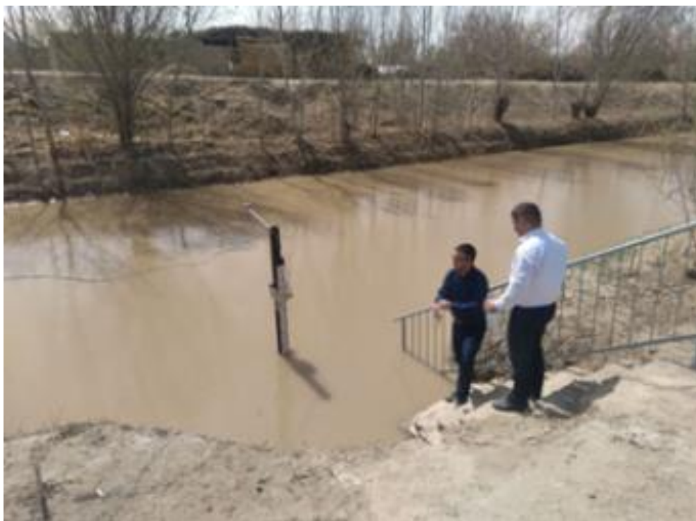
2-rasm. Qulobod kanalidagi Smart Water qurilmasi.
